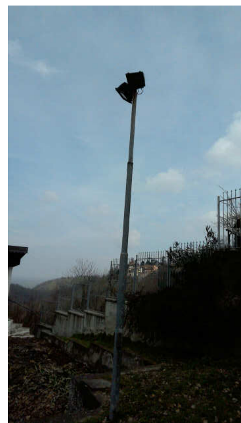
PALO STRADALE CON DUE PROIETTORI
