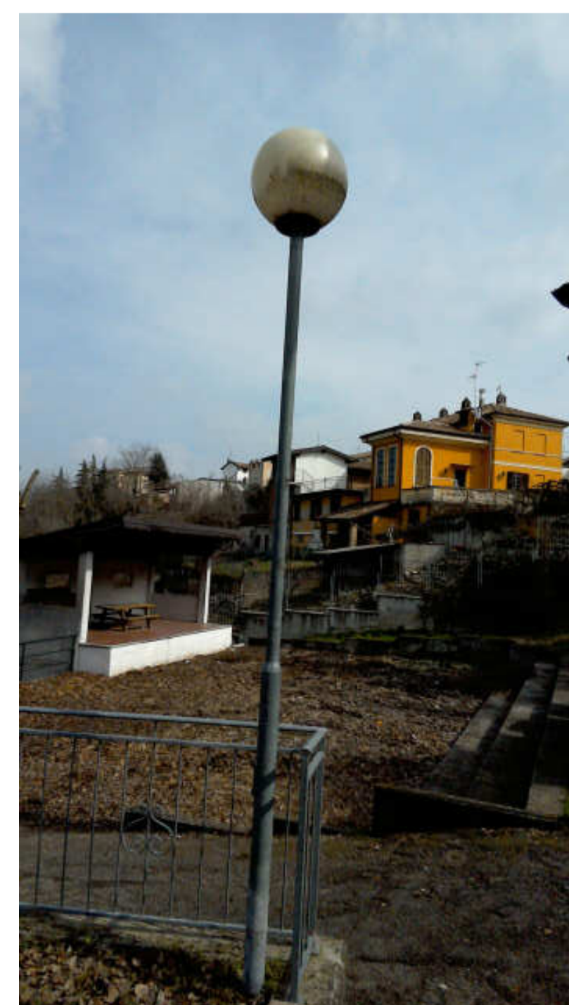
CORPO ILLUMINANTE DI TIPO GLOBO POSTO SU PALO
