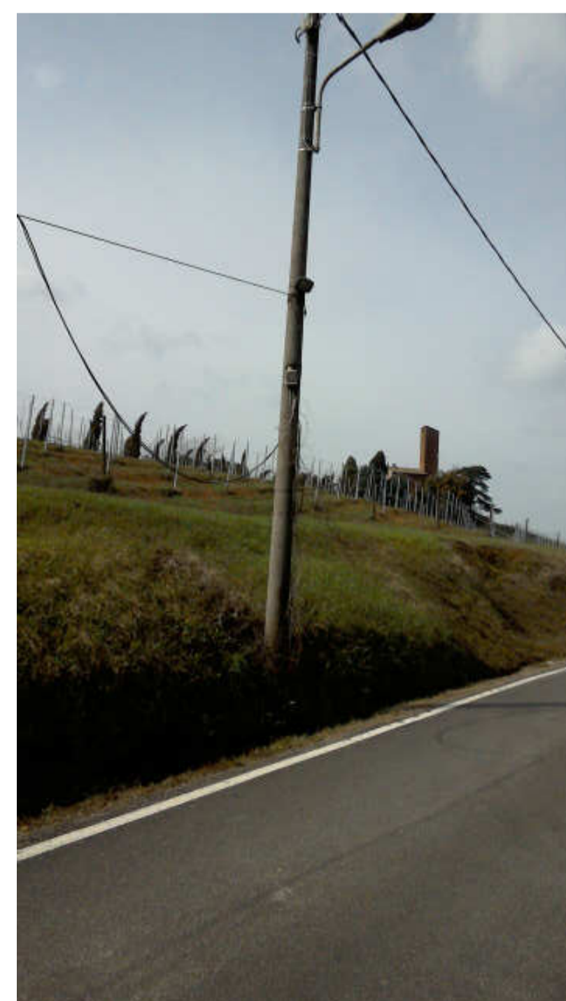
PALO STRADALE CON DUE CORPI ILLUMINANTI IL PRIMO DI TIPO STRADALE VETRO PIANO POSTO SU SOSTEGNO DI TIPO SBRACCIO IL SECONDO PROIETTORE STAFFATO AL PALO STRADALE
