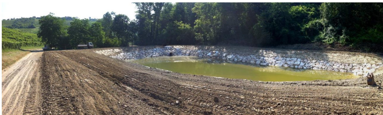
Foto 4: Ripresa fotografica del bacino di laminazione realizzato nel 2012.
